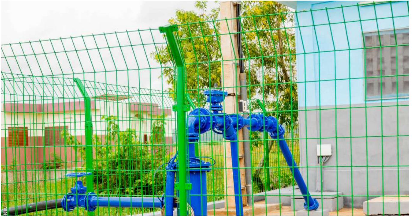
Equipements de la Tête de forage de la station de pompage
