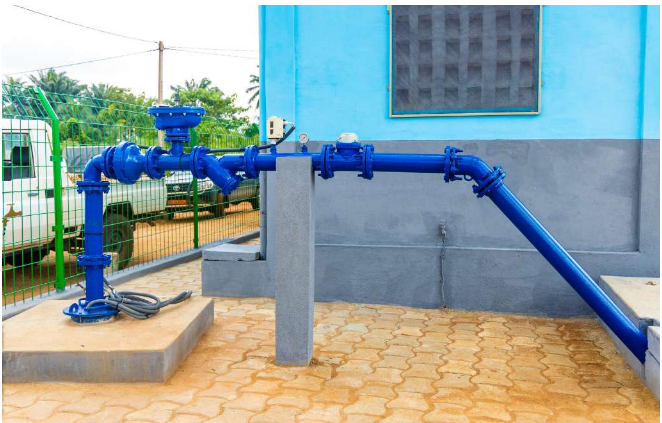
Equipements de la Tête de forage de la station de pompage
