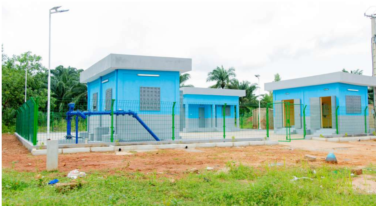
Equipements de la Tête de forage et locaux (Technique, Unité de chloration, et Administratif) de la station de pompage.
