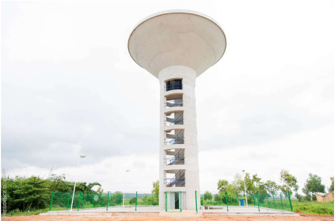
Château d'eau conique de 400 m 3 sur une hauteur sous cuve de 21 m
